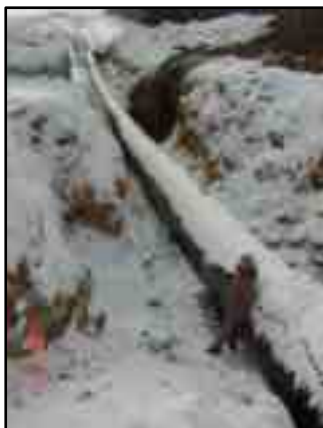
【ガスパイプライン 直径約122cm】
