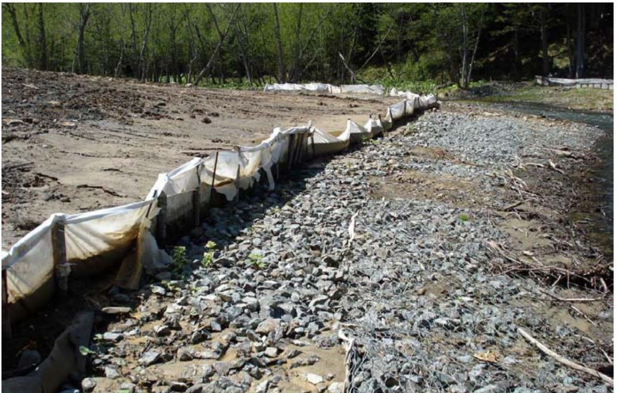
Рис. 6. Берег р. Приморская (ПК 482,6). Массы грязи, скопившиеся перед илоудерживающим экраном. Во многих местах ткань порвана или придавлена грунтом к земле. В сильный дождь грязь начнет поступать в реку.
