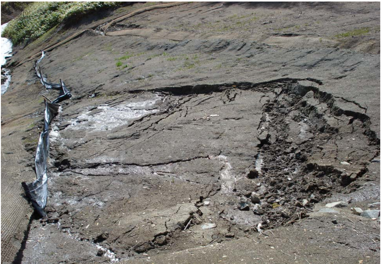
Рис. 12. Тот же оползень, что и на предыдущем снимке. Площадь сползающего участка около 25 м 2 .
