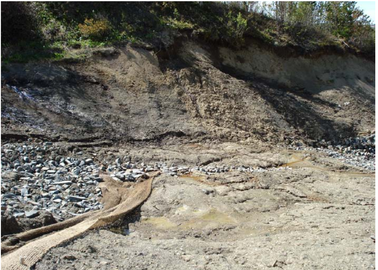
Рис 8. Правый борт р. Красная, ПК 460,4. Каменная наброска и геоджгут не могут удержать сползающий грунт. Необходим эффективный дренаж склона и полномасштабная биологическая рекультивация.
