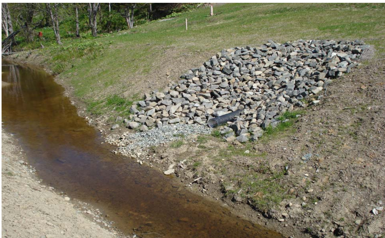
Рис.2. Выход подземного дренажа склона в долине р. Ай (ПК 504,8). На склоне имеется выход грунтовых вод, и обустроенная система дренажа предотвращает увлажнение и разжижение грунта.
