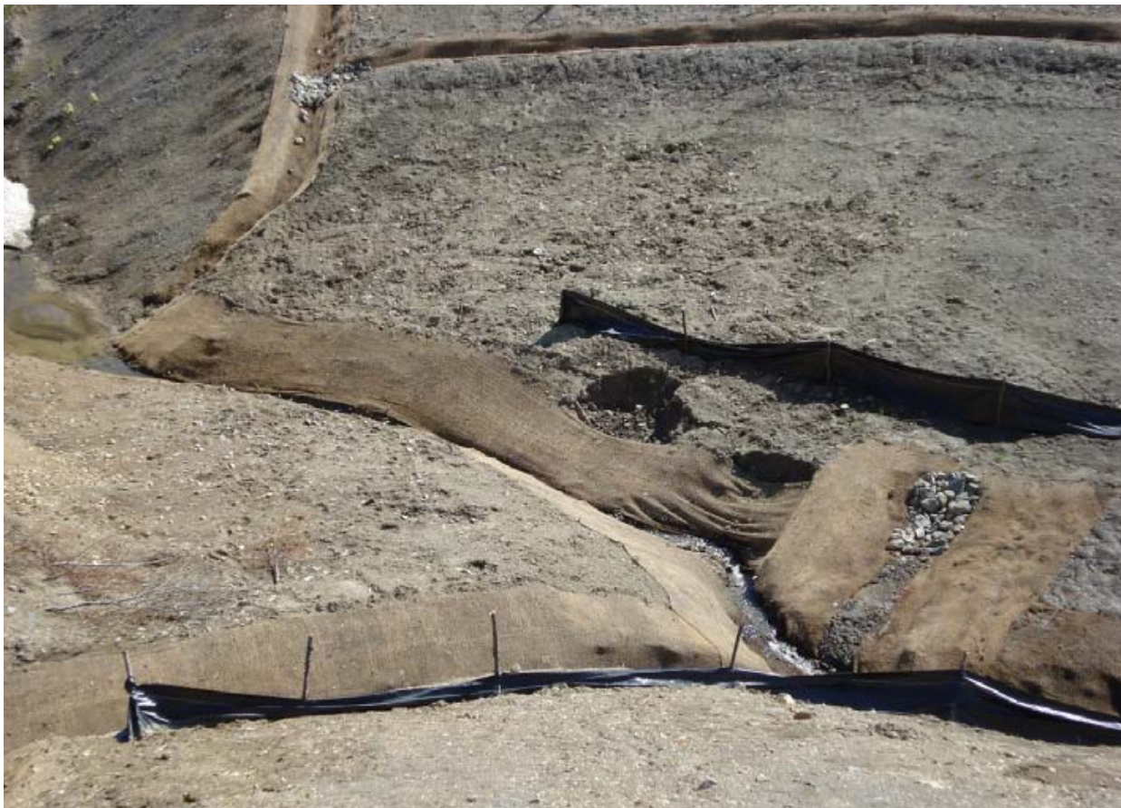
Рис 9. Мелкие оползни на левом борту правого притока р. Красная (ПК 461). Необходимы серьезные меры по стабилизации склона, включая дренаж и биологическую рекультивацию.
