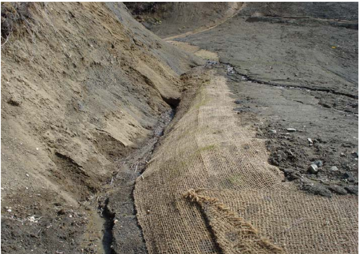
Рис. 14. То же место, что и на предыдущем снимке. Неукрепленный борт трассы осыпается во временный водоток, смывающий грунт в ручей.
