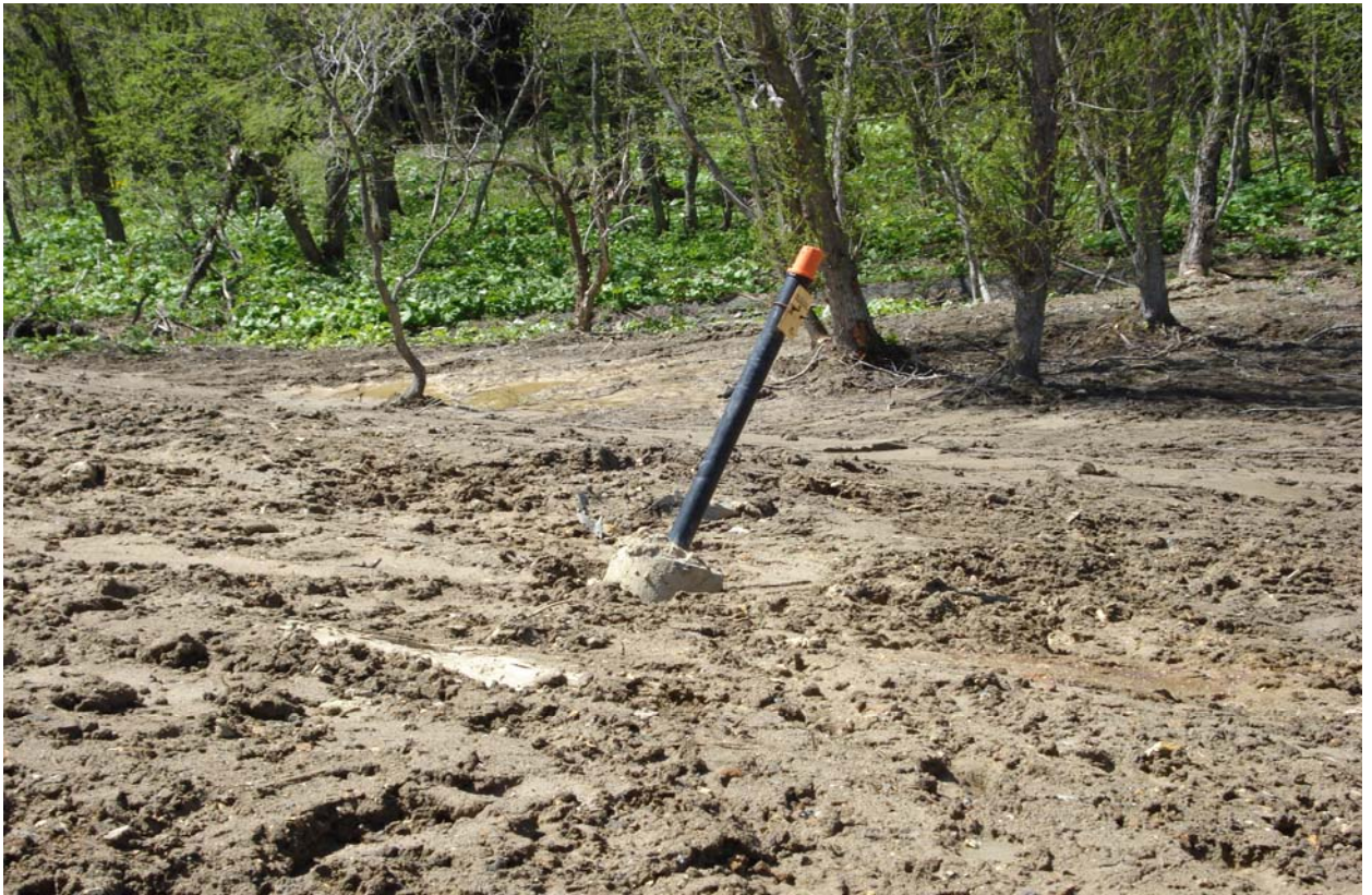
Рис. 7. То же место, что и на предыдущих двух снимках. Медленно сползающий грунт на правом берегу р. Приморская. Под напором разжиженных масс вывернут столбик контрольного пункта катодной защиты.
