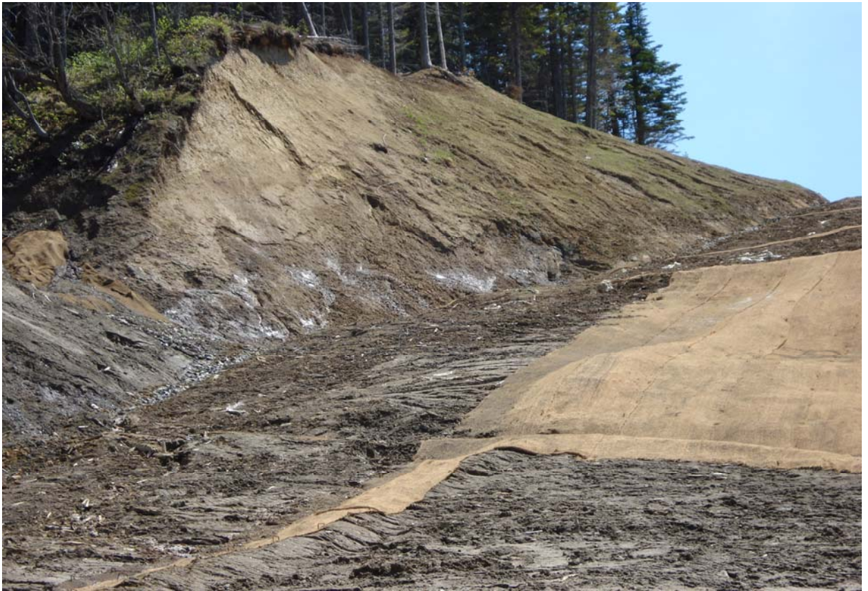
Рис. 5. Выход грунтовых вод на восточной стороне коридора трассы трубопроводов в 20 м южнее р. Приморская (ПК 482,6). Увлажненный грунт сползает по направлению к р. Приморская. Противооползневые мероприятия отсутствуют, биологическая рекультивация выполнена крайне недостаточно и не может стабилизировать склон. В ноябре 2007 г. здесь в результате оползня обнажилась закопанная нефтяная труба.
