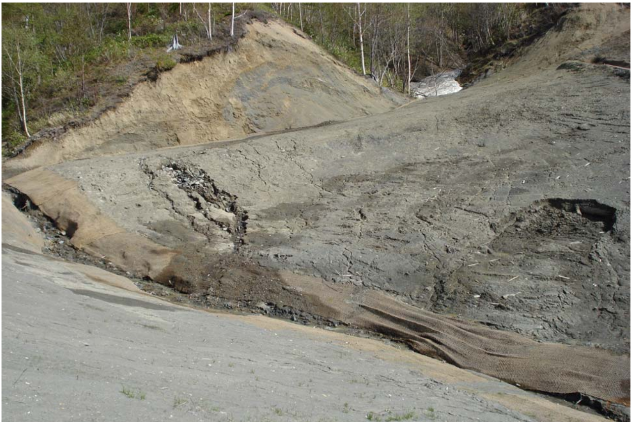
Рис. 13. Оползень на лев. борту следующего на юг прав. притока р. Красная (ПК 461,9) размером 6×3 м и слева от него растущая эрозионная рытвина. На левом берегу ручья повсеместно видны следы влажного грунта, свидетельствующие о близости грунтовых вод. Здесь также необходим дренаж склона и биологическая рекультивация.
